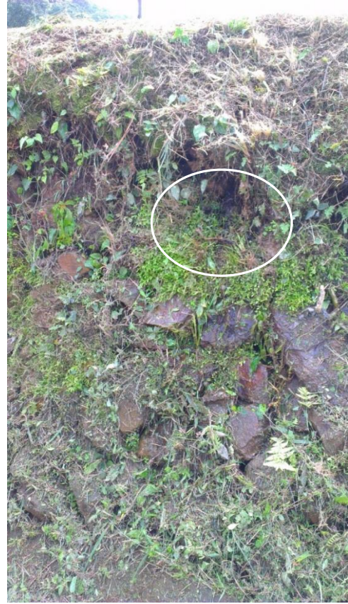
(c) 滲漏位置以邊坡中、高位置為主
