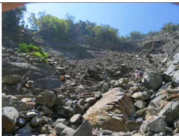
(16) 林道崩塌 (N22°58'10" E120°46'37")
