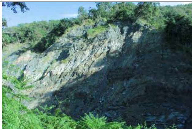
(2) 林道崩塌 (N23°02'08" E120°47'35")
