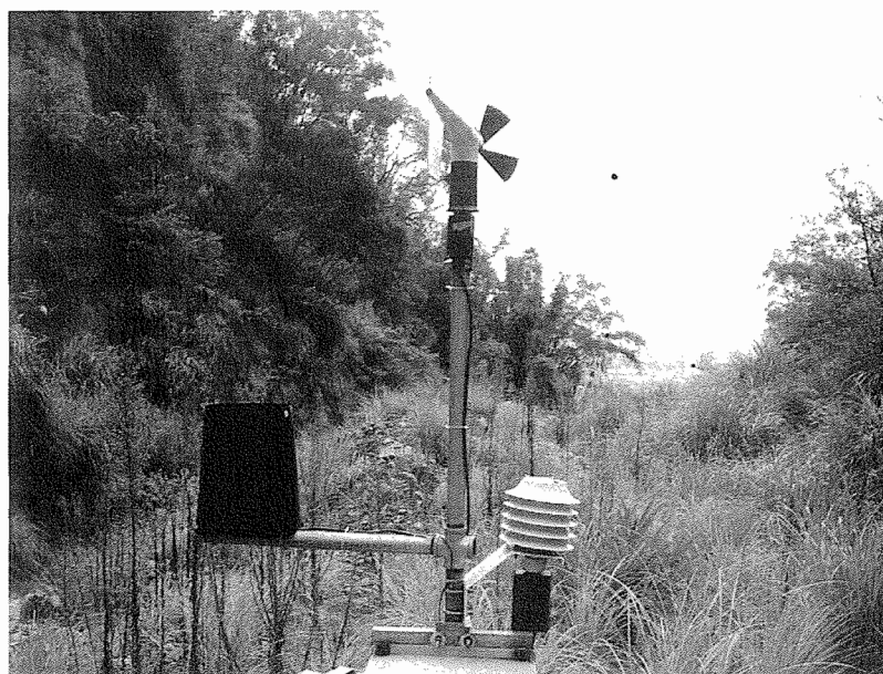
照片 4-3 風速風向計、溫溼度計與雨量計等感測器外觀
