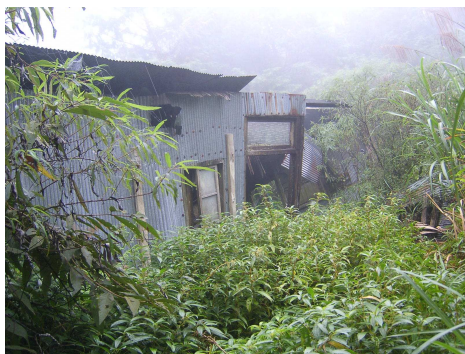
附圖 9. 光復林道 31.5K 之廢棄工寮
