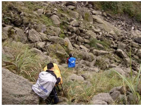
附圖 10. 光復林道沿途多處崩壁及碎石坡
