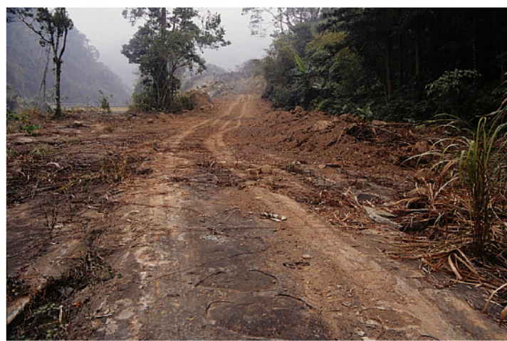
▶▶ 照片7：連珠池步道施工直接危及地景特質，同時在附近引發重大山崩，現在停工中。
