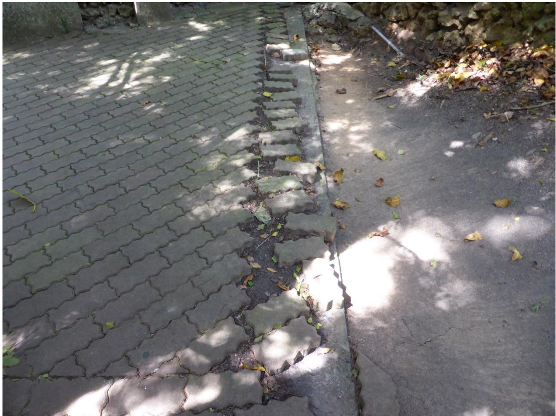
圖 5.30 石筍竇穴外地磚脫落情形
