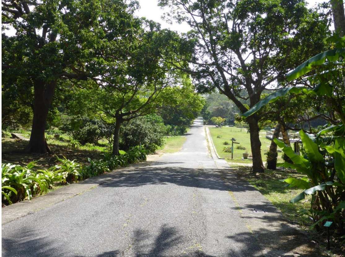
圖 5.31 道路發生龜裂
