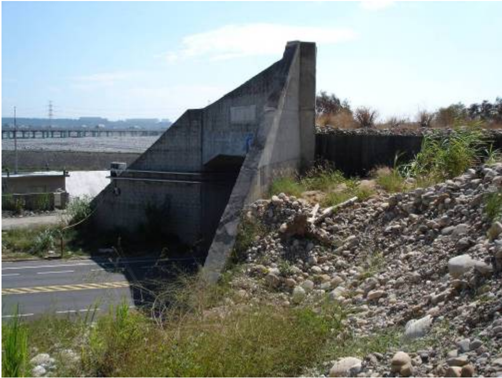
圖 5.31 莫拉克颱風後火炎山隧道東口上方情況
