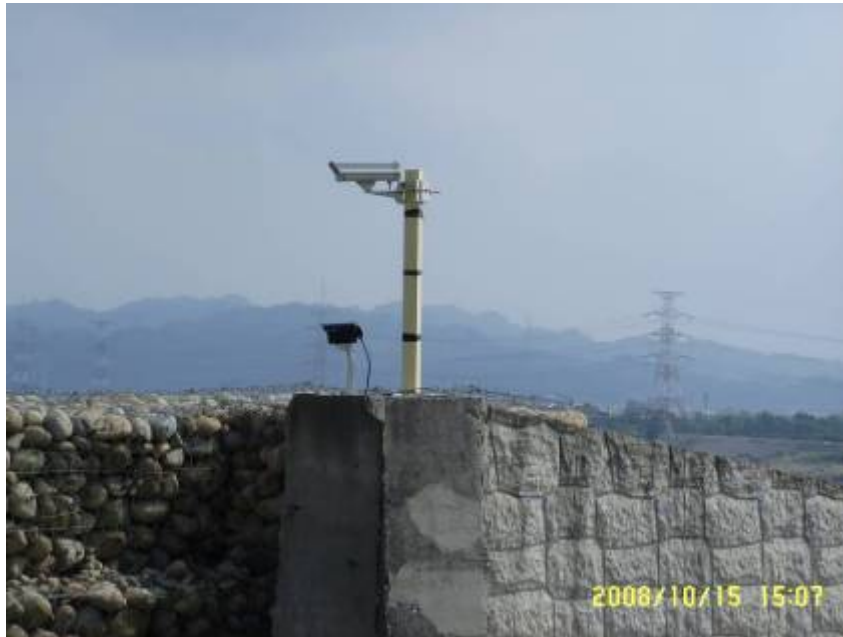
圖 4.5 西口影像監視器新架設位置 (2008/10/15)
