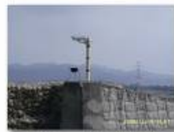
隧道西口影像監視器
