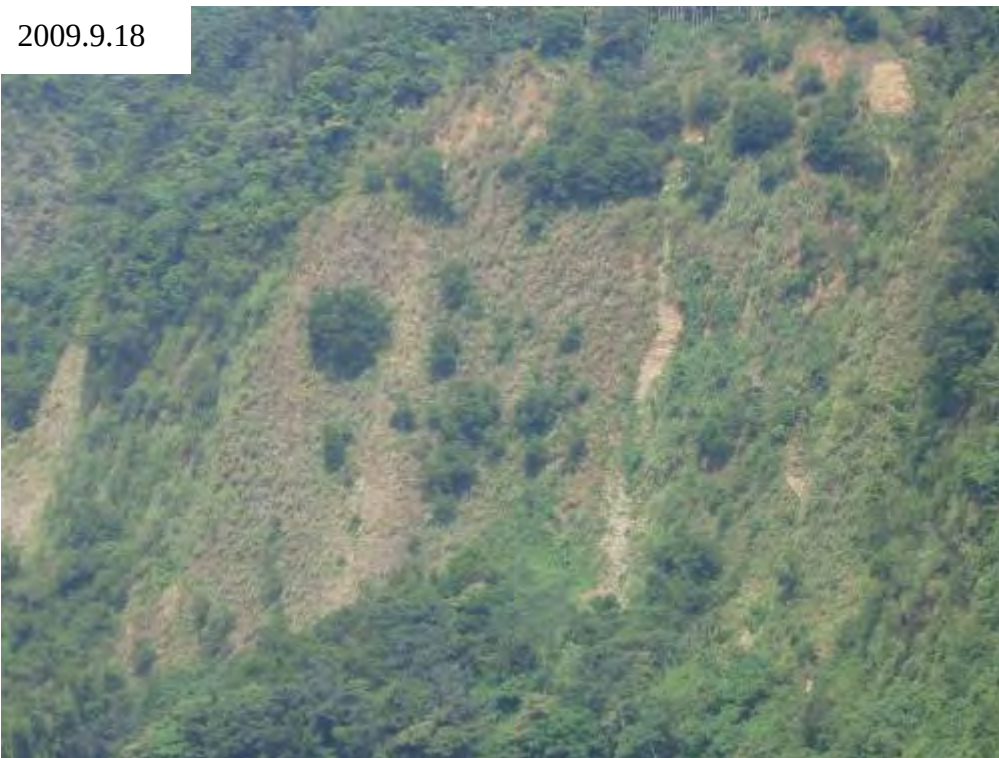
圖 61 樣點 3：石灼巷同心橋左前側崩塌地觀測比較圖
