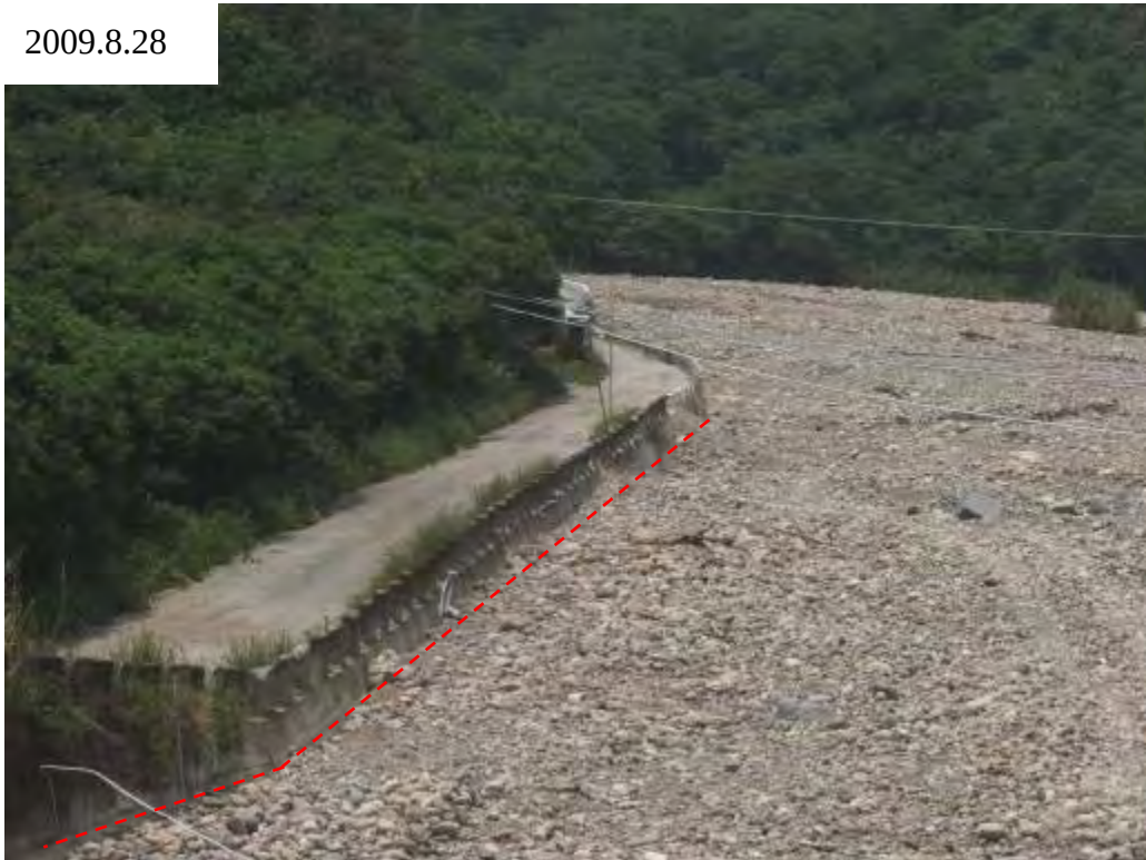
圖 64 過中心橋前方道路莫拉克颱風前後對照圖
