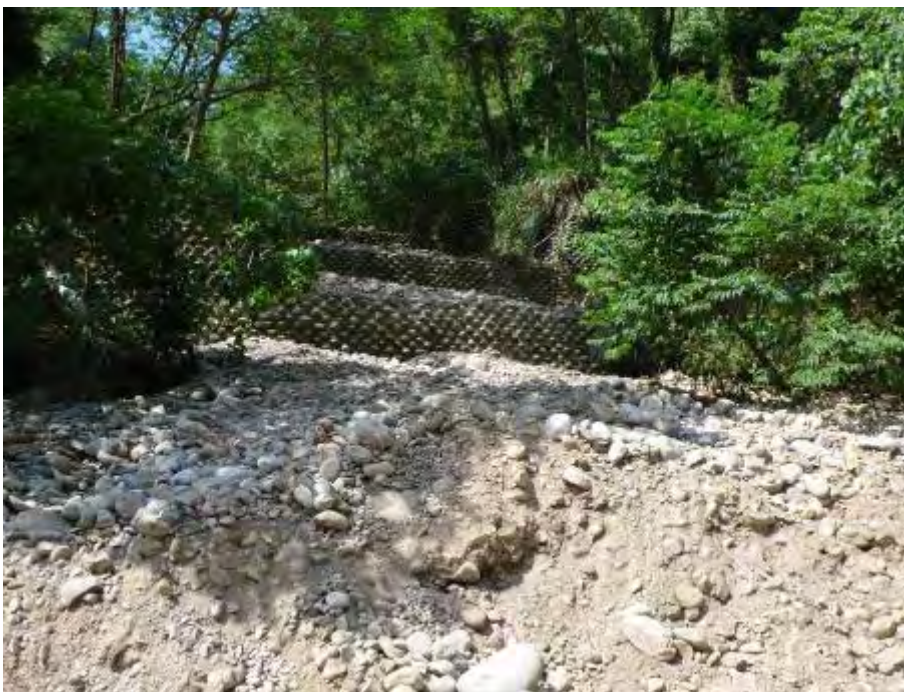
圖 33 辛樂克颱風後大量土石沿沖蝕溝被帶出 (227634,2655270)
