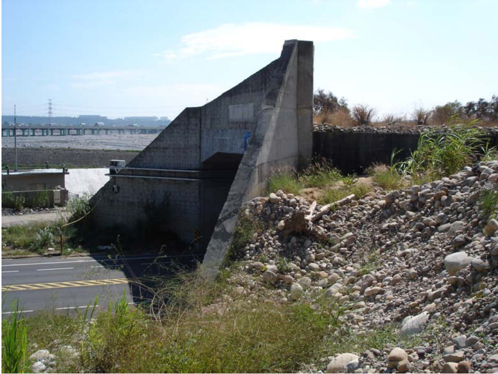
圖 53 莫拉克颱風後火炎山隧道東口情況 2
