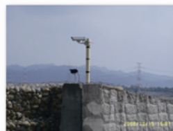
隧道西口影像監視器
