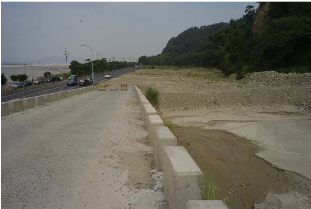
圖 45 從土堤往下看，土泥內側有一小土堤
