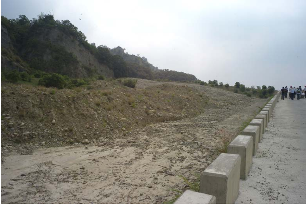
圖 44 隧道西口土堤內側土石堆積情況
