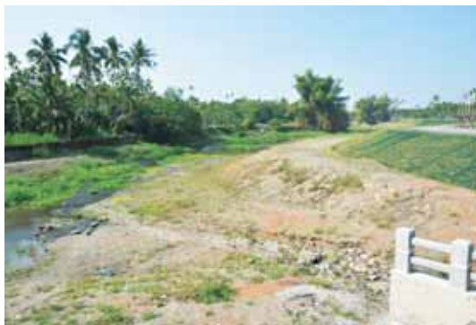
2013 年下游施工後，河道被拓寬，生態區原生植被消失。
