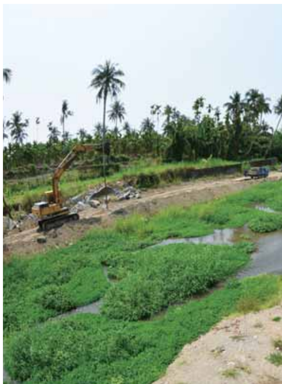
未經審慎評估即進行的工程，戕害了湧泉生態環境。圖為2014年4月在屏東五溝水進行的舊護岸翻新工程。
