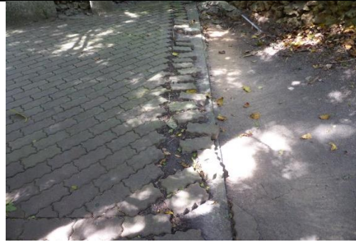
石筍寶穴外地磚脫落情形
