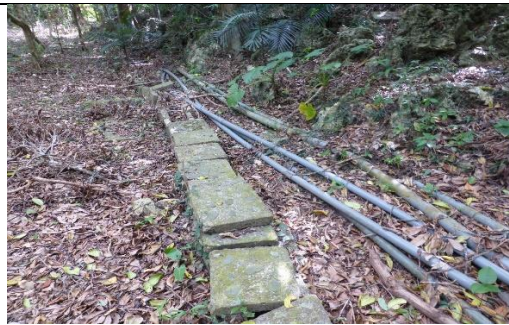
山區引水用之水管
