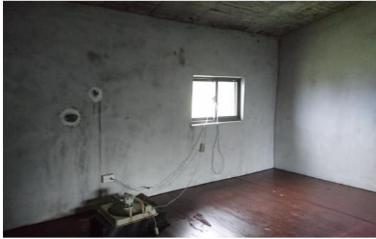
壁面滲水狀況
