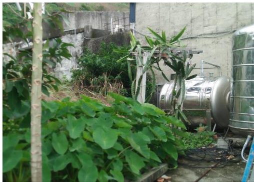
105 年度安裝的一噸水塔
