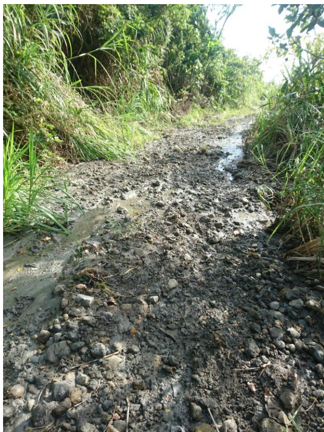
往水源頭的產業道路同樣常因風雨而坍方（已由村長委請工程單位清除）
