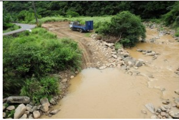
遠望坑溪工程對水質造成嚴重影響
