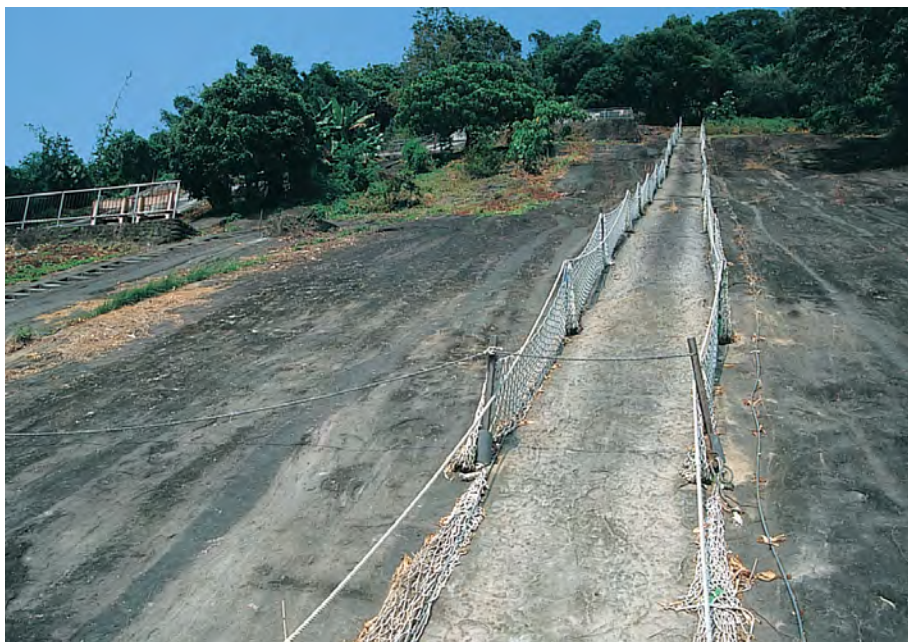
照片5 峭壁雄風是一處岩層順著層面往下滑動、斷裂而成的陡峭岩壁。
