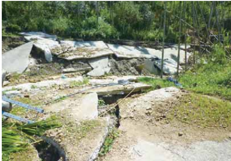
照片36 在2009年的莫拉克颱風造成921地震紀念地聯絡道路的路基嚴重損壞
