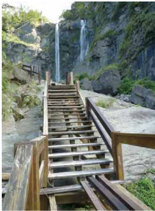
照片35 損毀的蓬萊瀑布步道
