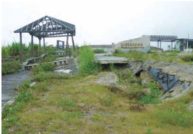
照片37 飛山觀景臺在2009年莫拉克颱風時造成崩塌位移
