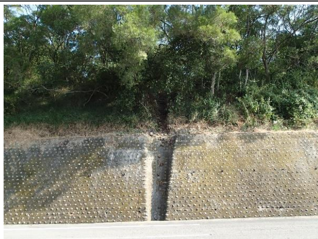
圖 20、高約 5 m 的陡峭擋土牆
