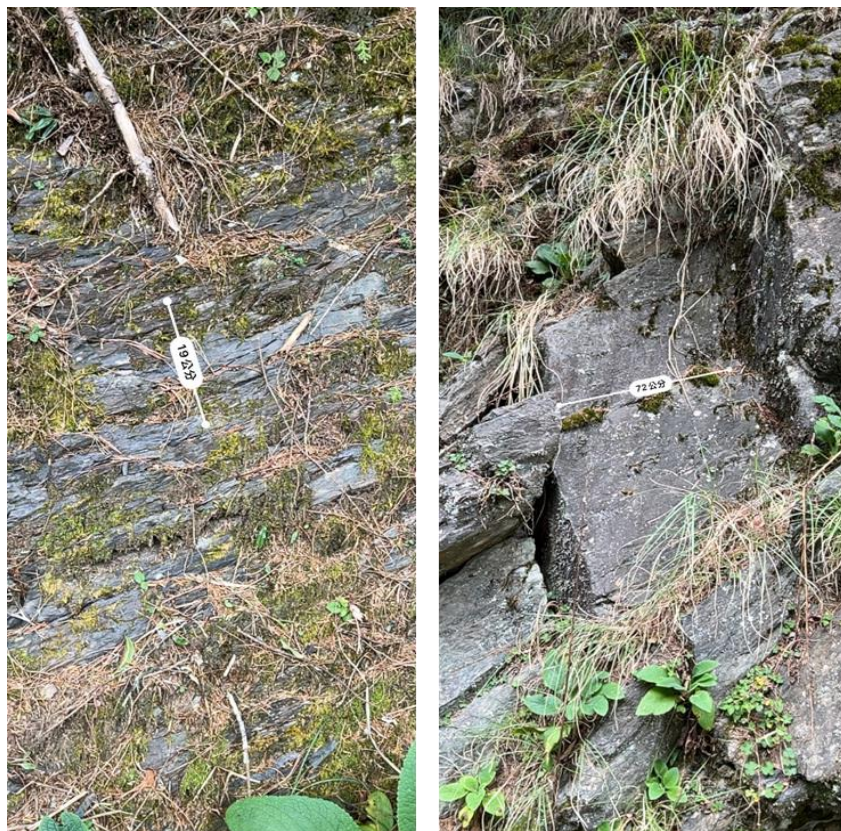
圖 26、位於 200 林道 46.5K 處，樹葉化石邊坡的硬岩與軟岩
