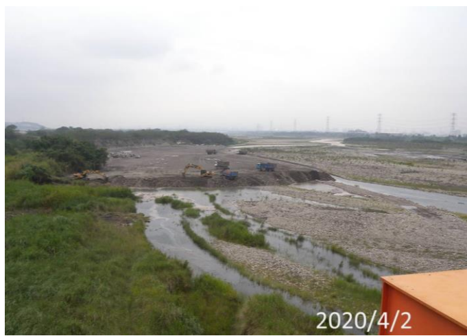
照片 8、承照片 7，今年施工填土，構築砂石車便道，原本棲息支流已被填平。
