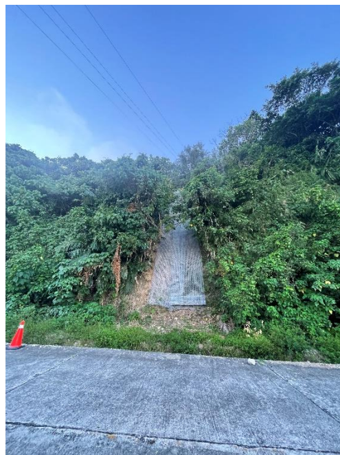
綠島東側山坡，有數處邊坡滑落現象。
