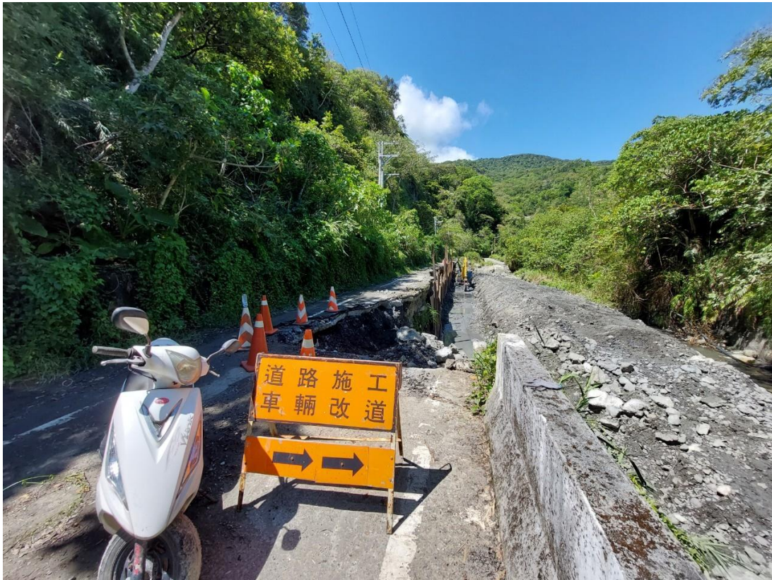
圖十一、地震及豪雨造成瑞港(RG)調查樣區道路崩塌毀損。
