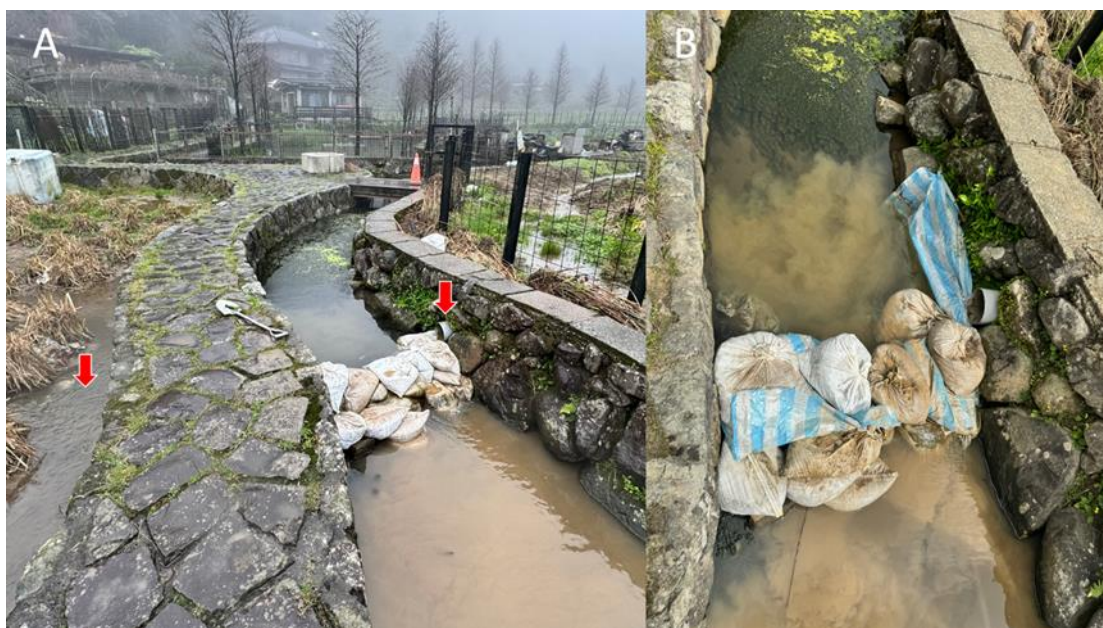
圖 26：藉由設置臨時性沙包阻擋渠道水流改善因步道切割的赤腹游蛇棲地水文 與棲地連通性（A 紅色箭頭處）及後續增加帆布提高阻水效率（B）（攝 影者：毛俊傑）
