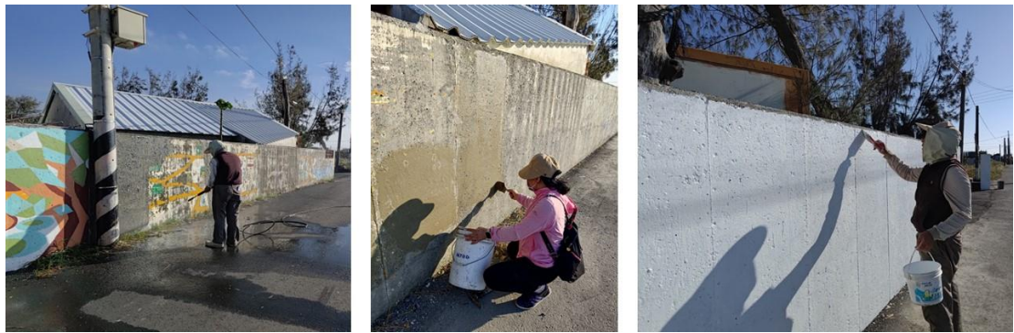
▲B 處因牆面斑駁，與屋主進行溝通後，請師傅用水刀先將牆面清理，再用水泥將坑洞填補與塗上白漆。
