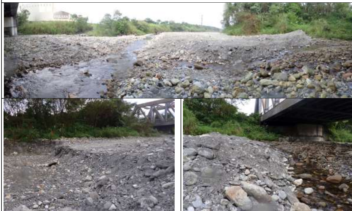
疏濬撤場時在鐵路橋下方的疏濬終點，成為比上游高的土石堆，農水署 B 開口的右側流路被迫在鐵路下 90 度轉彎攻擊左岸，在大水時也有回壅的壓力。
