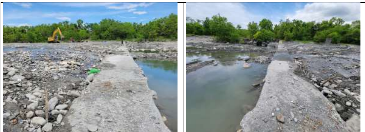
8/18 切截工程撤場時的狀態，勉強將截水牆和護坦間出露石籠覆蓋，掏空間隙填埋。
